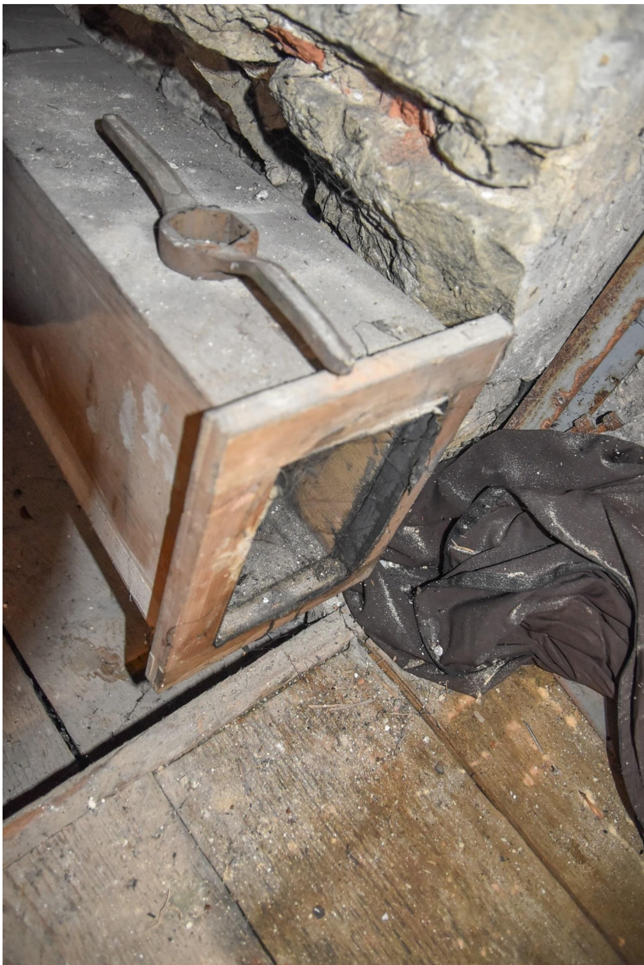
Fotografia 71 – miejsce podłączenia pierwotnej lokalizacji dmuchawy elektrycznej w pomieszczeniu na chórze
