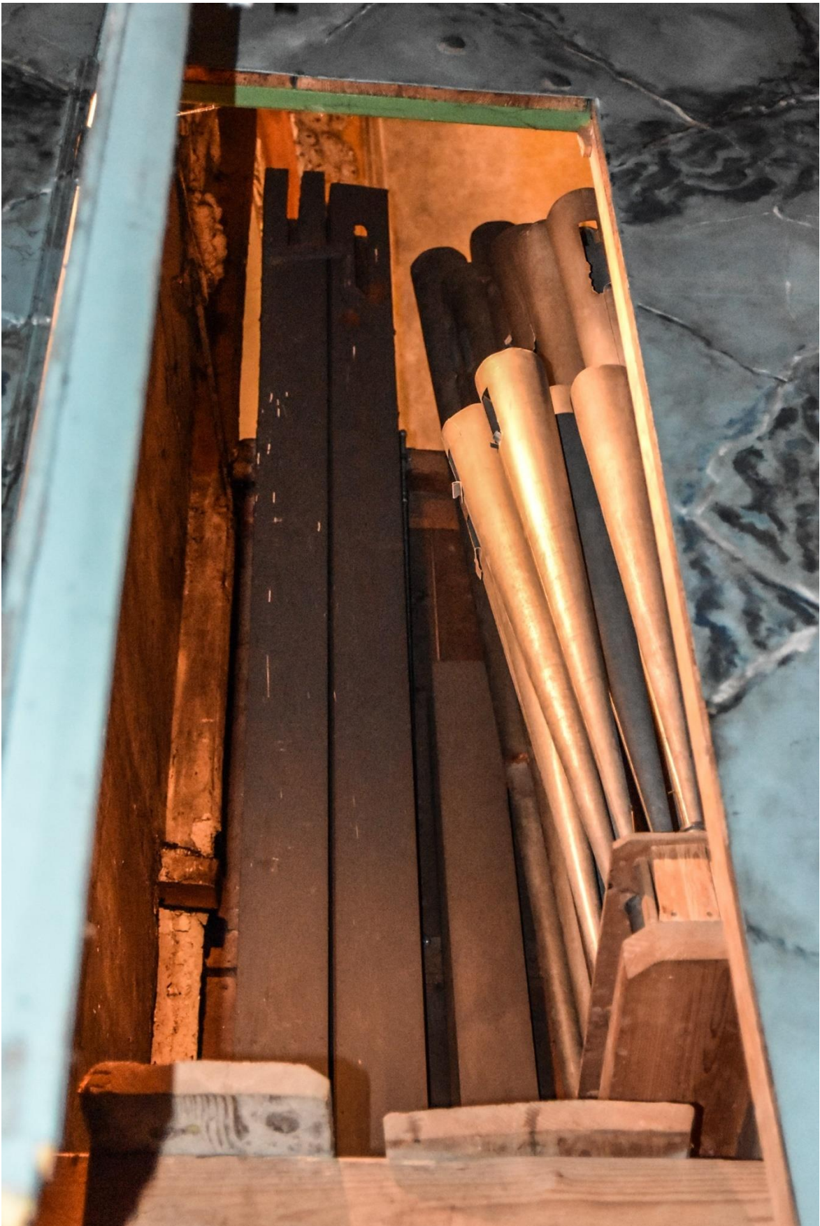
Fotografia 17 – odchylone od pionu wskutek braku odpowiedniej stabilizacji rezonatory pedałowego głosu językowego; z tyłu odstawki najniższych tonów (C, Cis oraz C) registrów Kontrabas 16` oraz Subbas 16`
