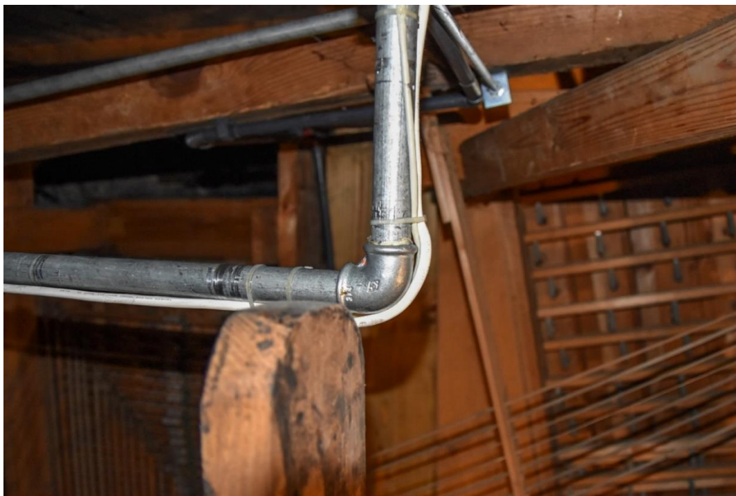
Fotografia 2 – wtórnie zainstalowana instalacja przeciwpożarowa wyklucza swobodny ruch mechanizmu różnicowego łączącego dwie dźwignie klinowych miechów pełniących funkcję podawaczy
