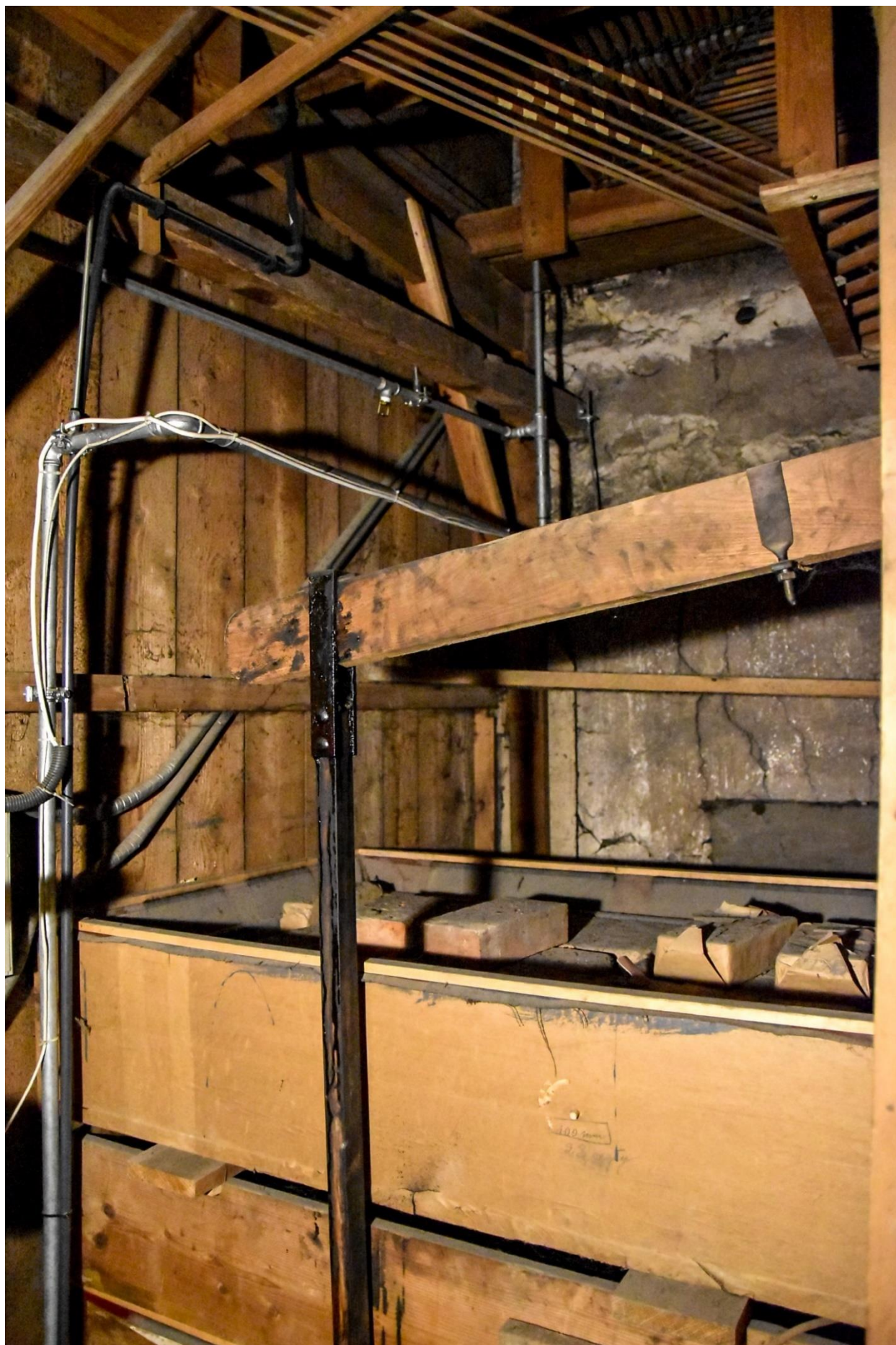
Fotografia 46 – Dźwignia kalikancka blokowana przez rurę systemu przeciwpożarowego, pełniącą również funkcję stabilizującą dla wiązki kabli elektrycznych, wierzchnia część pływaka z obciążnikami w postaci cegieł
