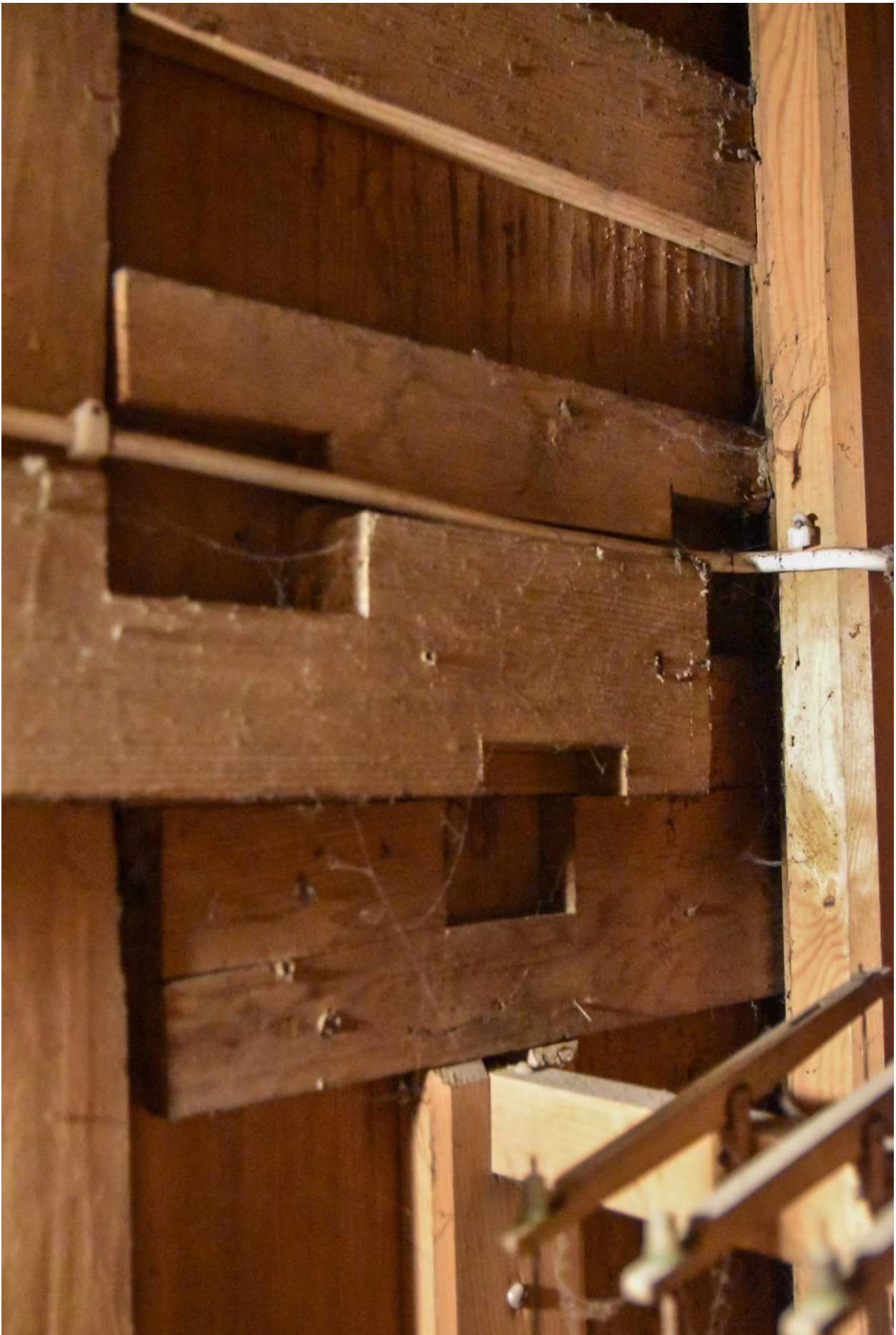
Fotografia 42 – ślady przebudowy szafy
