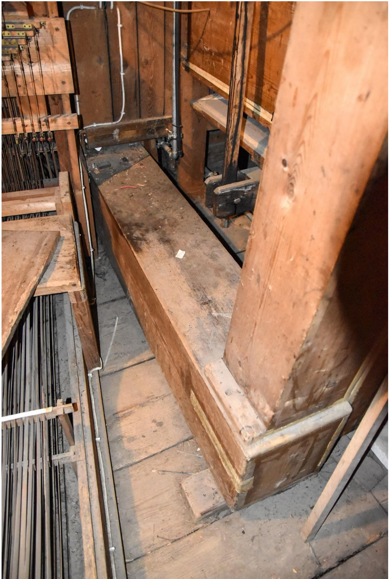
Fotografia 64 – kanał wiatrowy przekazujący powietrze do szafy południowej, w tle mechanizm czerpaka, po lewej powykrzywiane abstrakty stabilizowane prowizorycznie mocowanym grzebieniem
