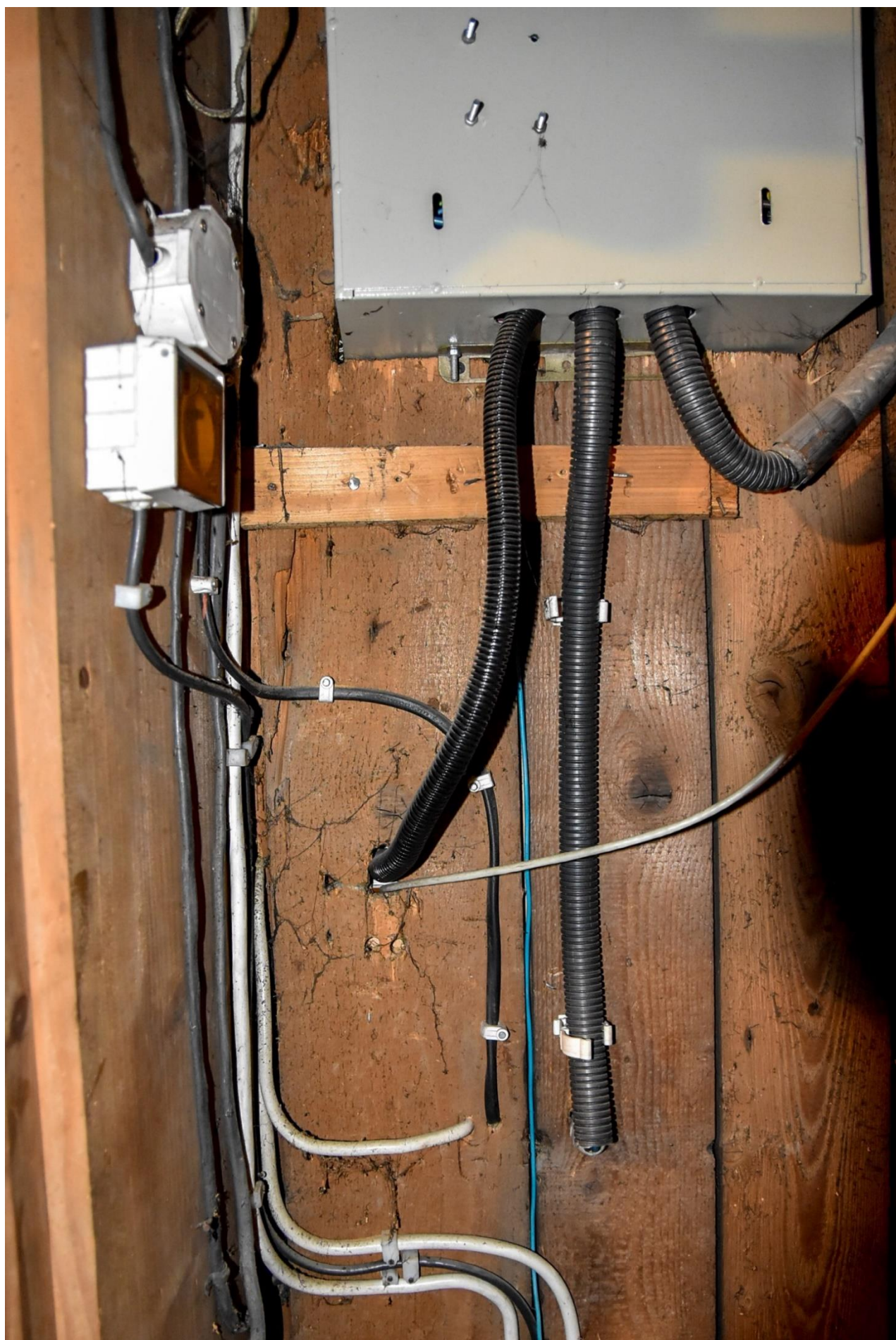
Fotografia 60 – nieuporządkowana instalacja elektryczna wewnątrz szafy organowej
