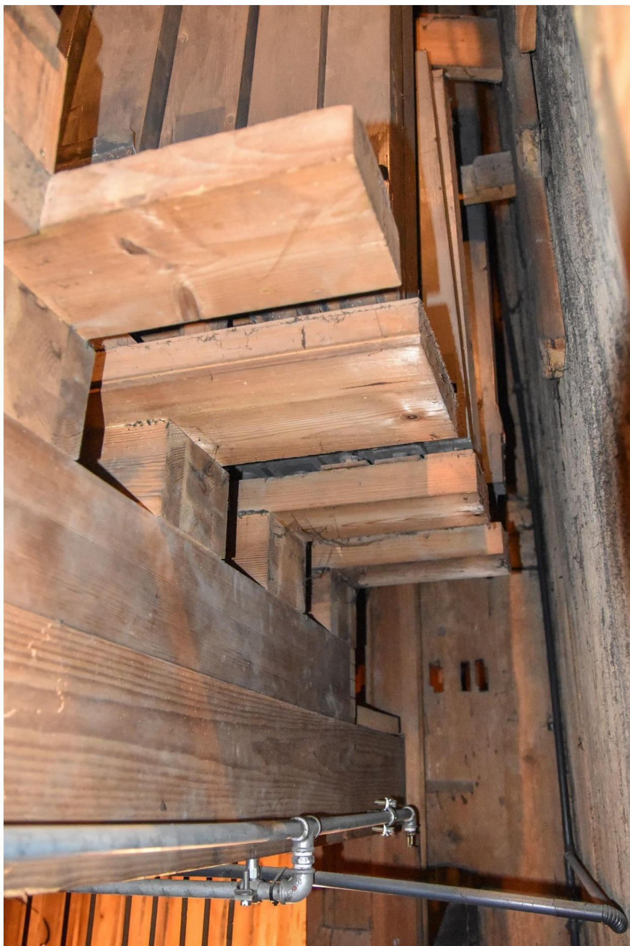
Fotografia 134 – wiatrownica sekcji pedałowej z zainstalowanym do jej struktury systemem przeciwpożarowym
