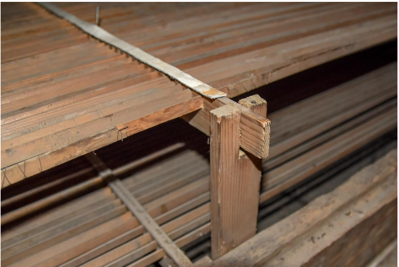
Fotografia 59 – prowizorycznie osadzone mocowanie stabilizatora ciągu traktowego tuż przy tylnej stronie kontuaru
