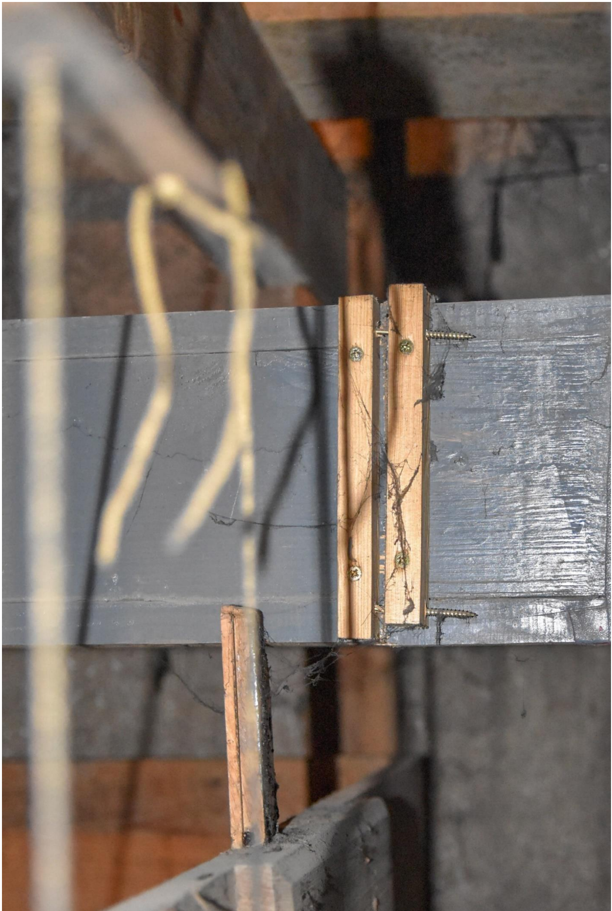
Fotografia 68 – wzmocnienie połączenia kanałów wykonane za pomocą niepasujących listewek drewnianych, wkręconych za pomocą zbyt długich śrub w nierówny sposób
