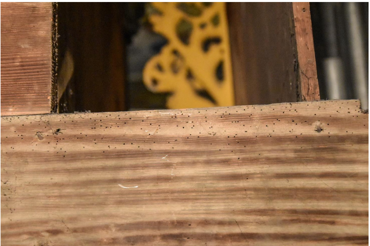
Fotografia 127 – otwory w elementach drewnianych powstałe przez działanie drewnojadów
