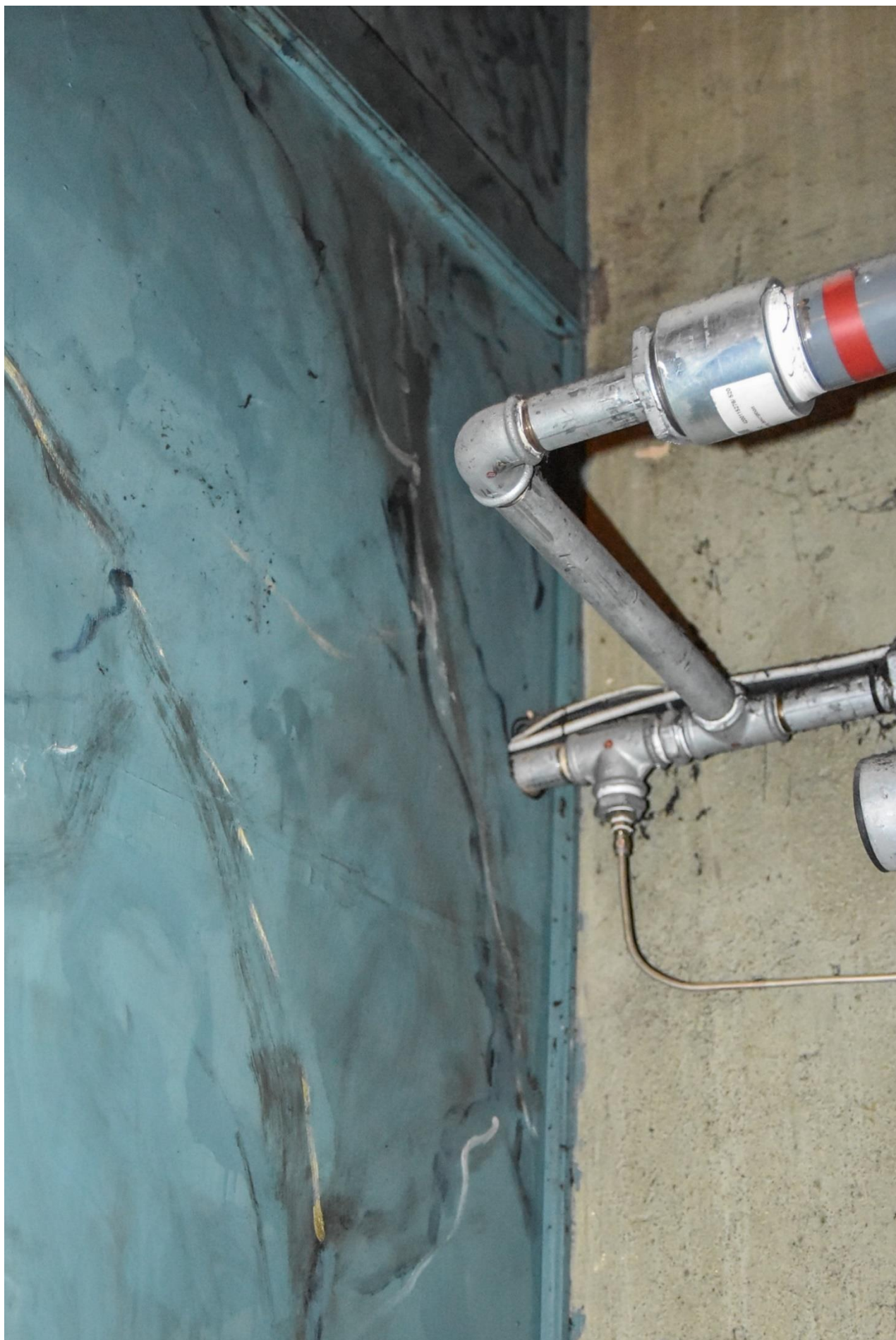
Fotografia 70 – przyłącze stałych urządzeń gaśniczych na rogu ściany zachodniej i północnego boku szafy manualowej
