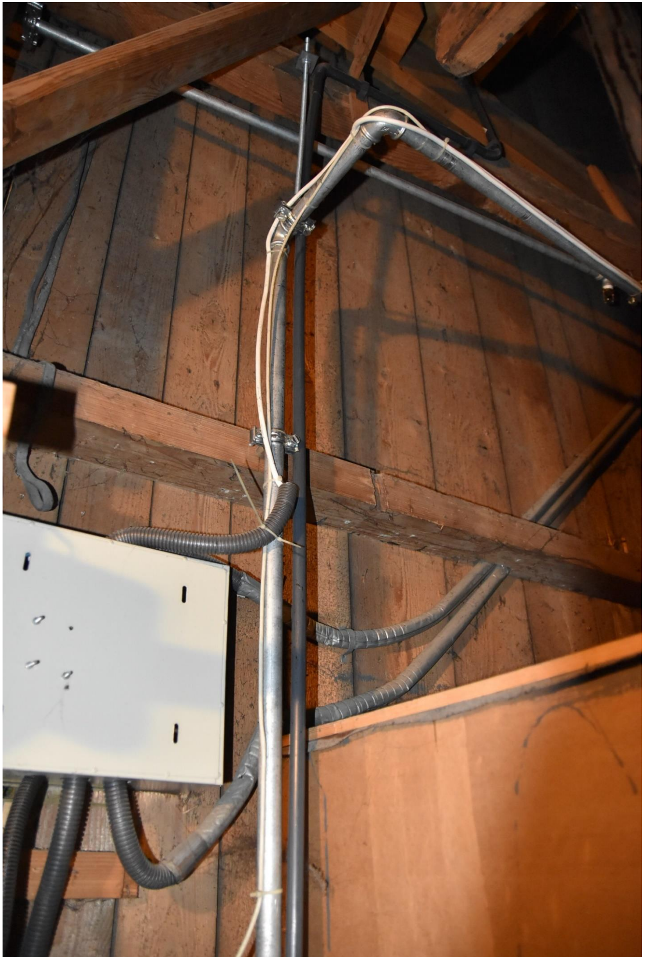
Fotografia 40 – prowadzenie kabli elektrycznych oparte o rury systemu przeciwpożarowego
