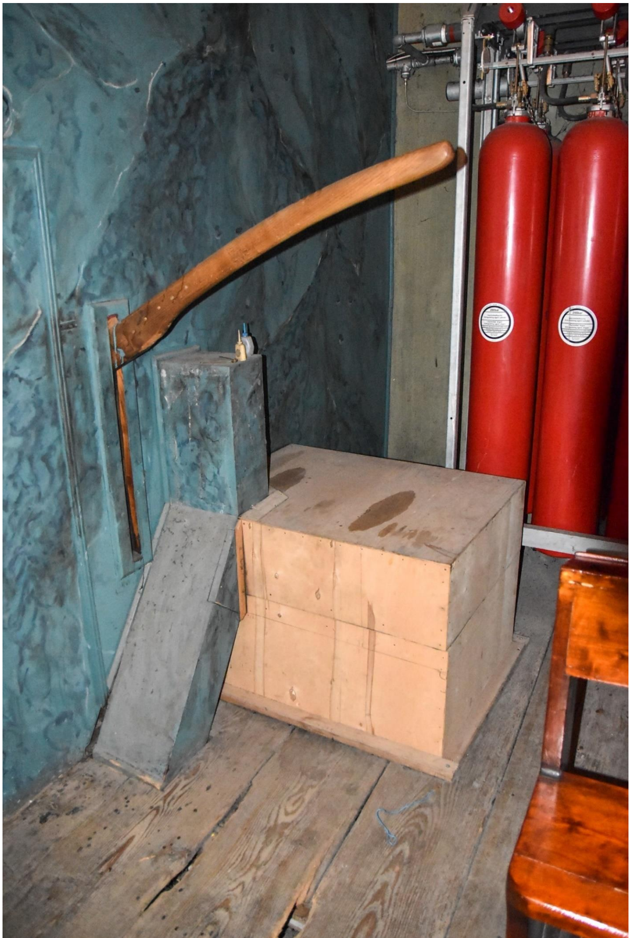
Fotografia 29 – bok szafy północnej, dmuchawa elektryczna w ochronnej skrzyni podłączona do kanału wiatrowego, dźwignia kalikancka, w tle urządzenia systemu przeciwpożarowego
