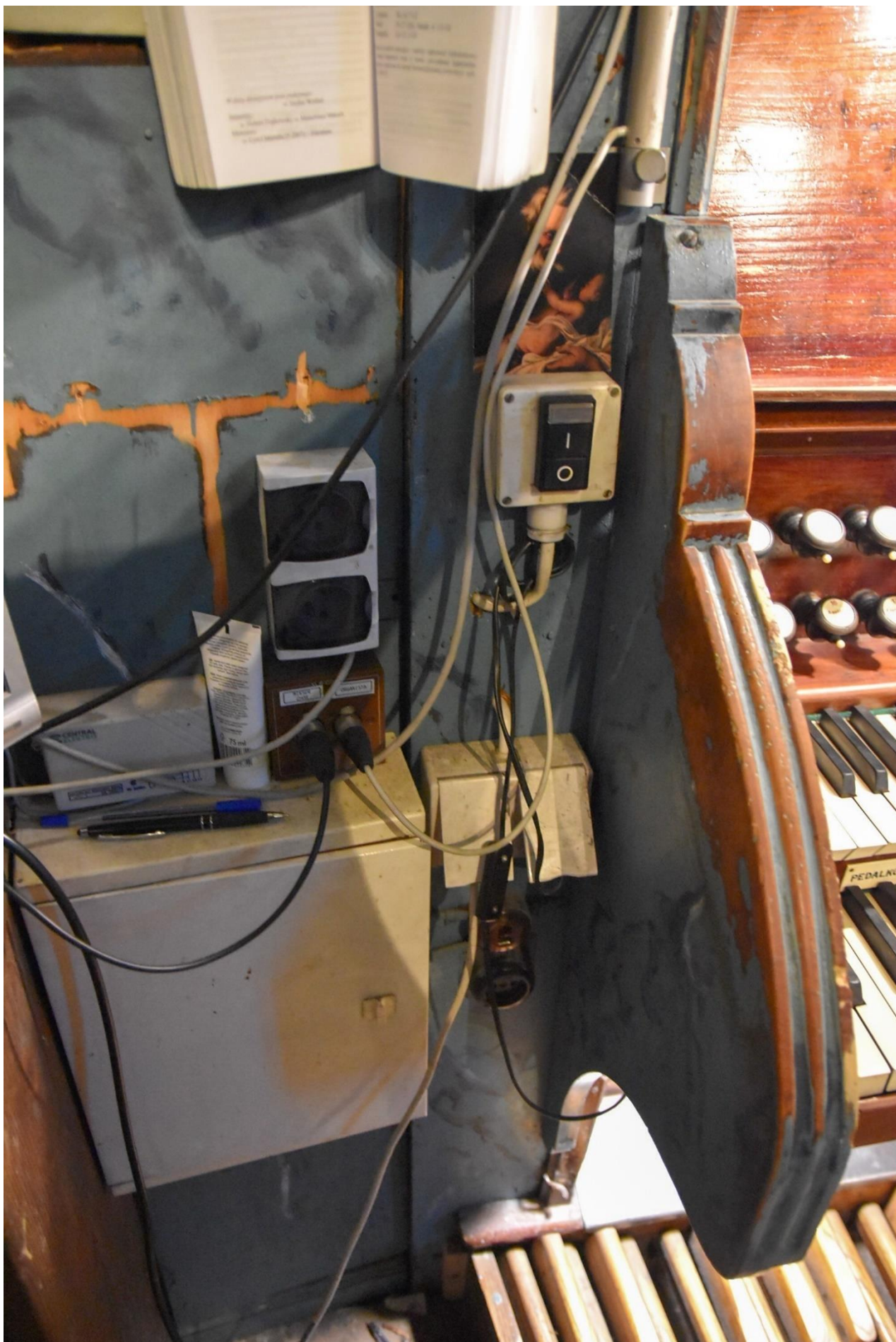
Fotografia 27 – kłębowisko kabli po lewej stronie kontuaru
