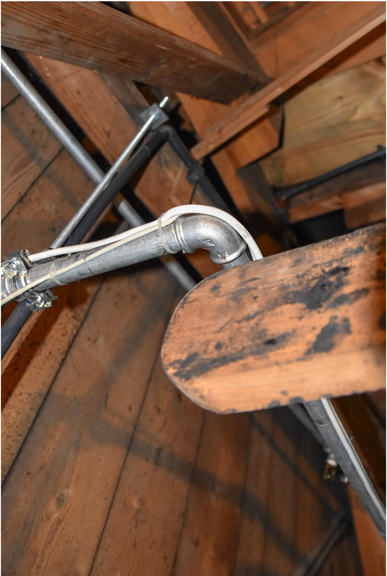
Fotografia 55 – rura systemu przeciwpożarowego blokująca swobodny ruch dźwigni kalikanckiej
