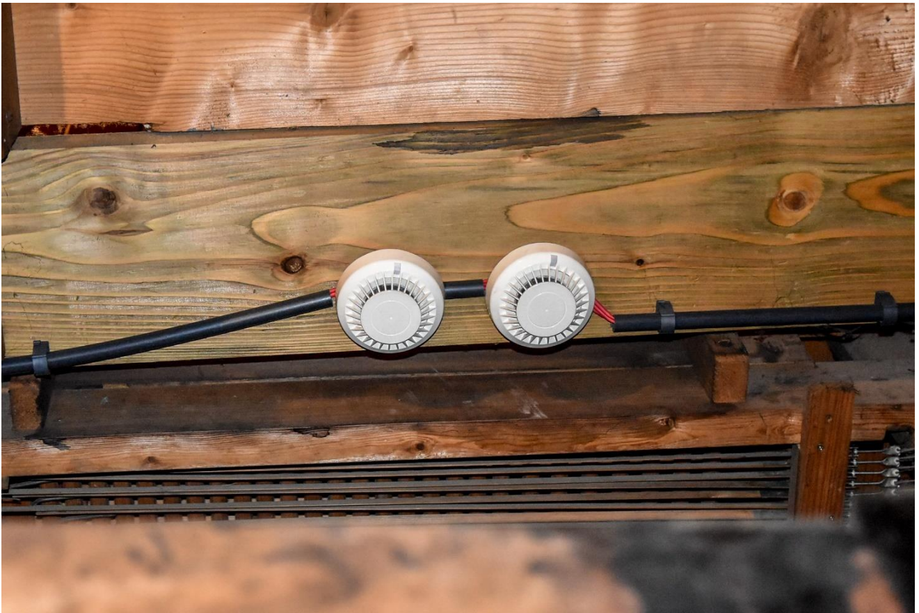
Fotografia 52 – czujki systemu przeciwpożarowego, obok nich prowadzenie abstraktów traktury mechanicznej
