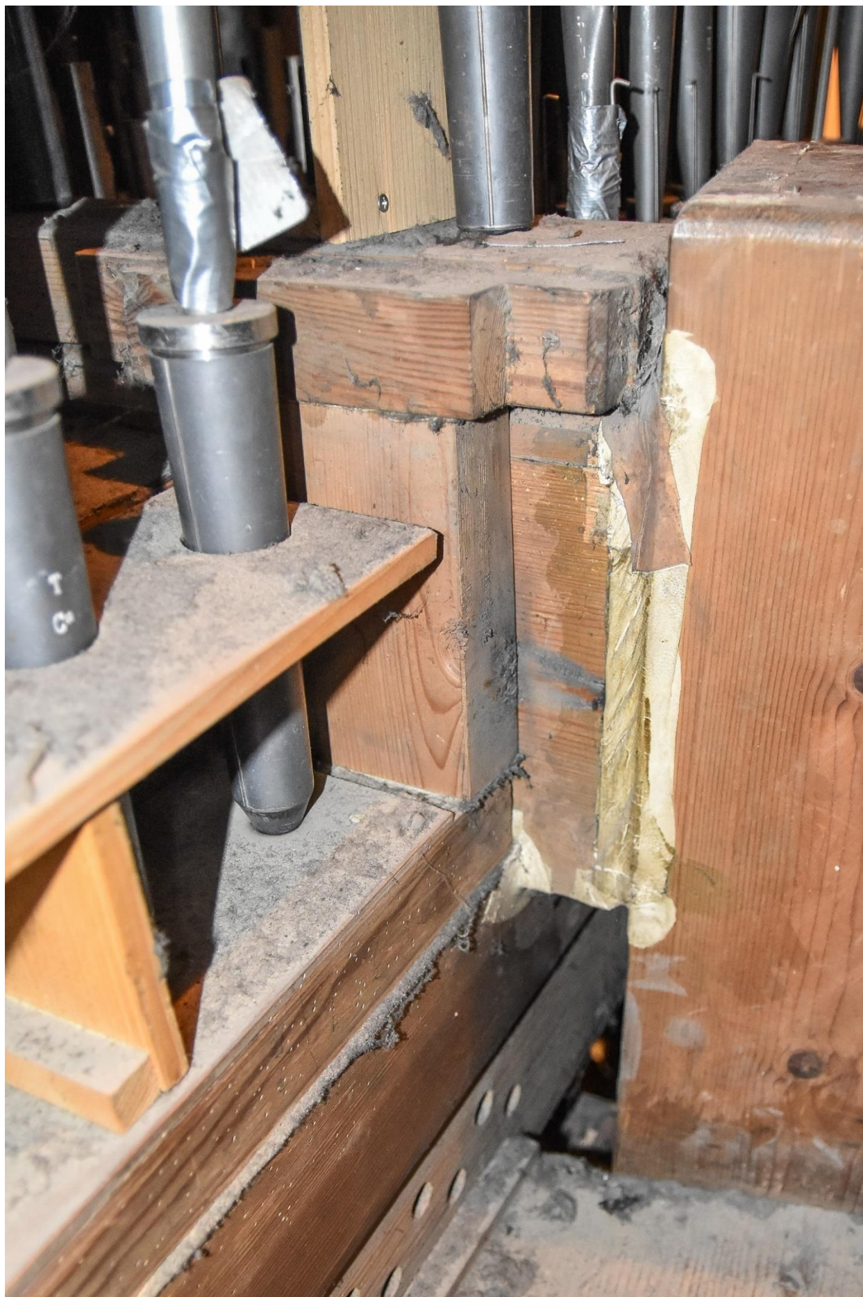
Fotografia 90 – wielowarstwowe próby uszczelnienia połączenia kanału powietrznego z wiatrownicą manuału głównego
