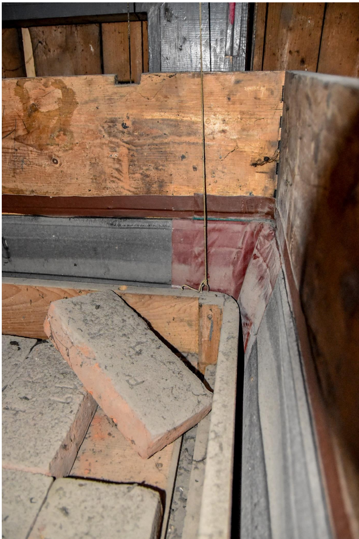
Fotografia 63 – wierzchnia część miecha, widoczna olbrzymia warstwa kurzu, brak opakowania cegieł obciążnikowych, sznur łączący pływak ze skrzynką regulującą oraz nierówne uszczelnienie za pomocą materiału skóropodobnego
